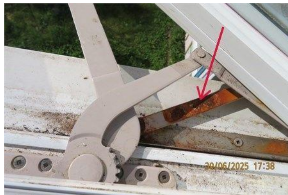
Fenêtre - mécanisme d'ouverture corrodé - Salle de bain
