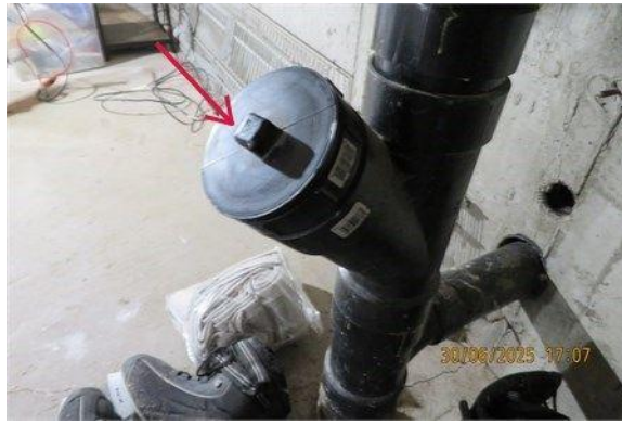
Regard de nettoyage
