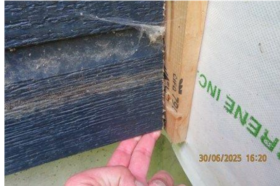
La fixation du revêtement extérieur n'est pas adéquat.
