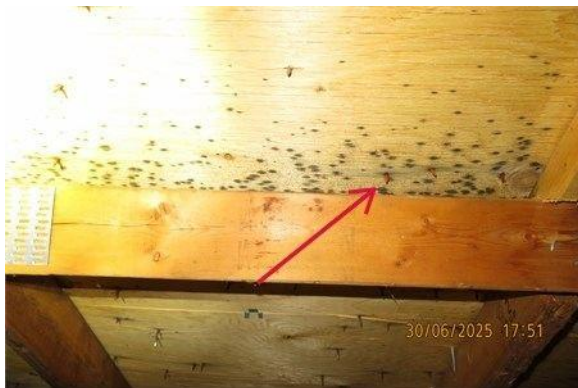
Signe d'infiltration et taches noir dans l'entre- toit
