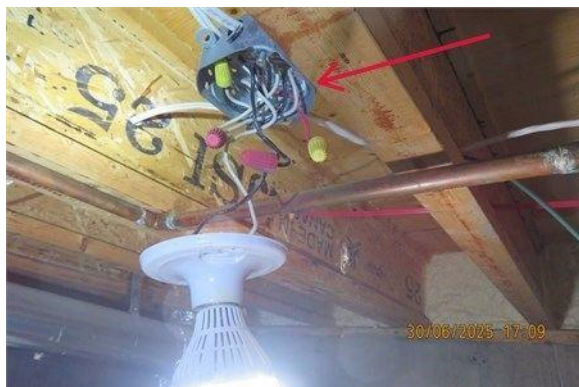
Connexion électrique ouverte ou inadéquate
