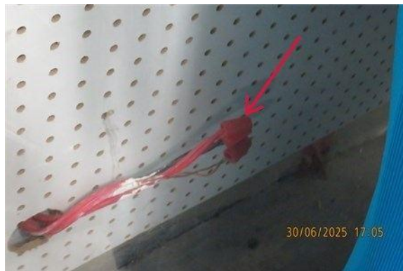
Filage - Câblage électrique à découvert - Garage
