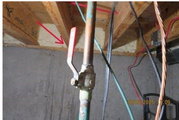
Valve principale d'entrée d'eau
