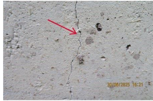
Béton - Fissures mineures à réparer - Côté droit
