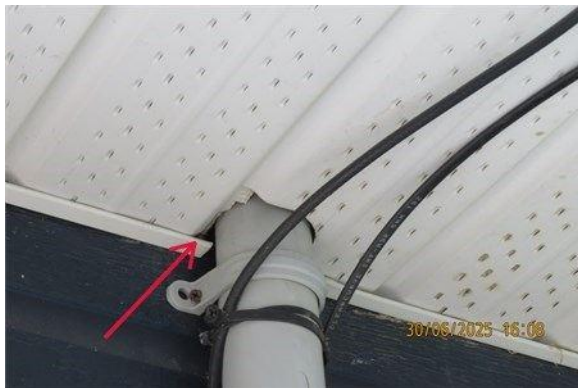
Joints de scellement - Ouvertures non scellées
