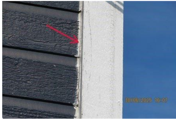
Joint de scellement à refaire
