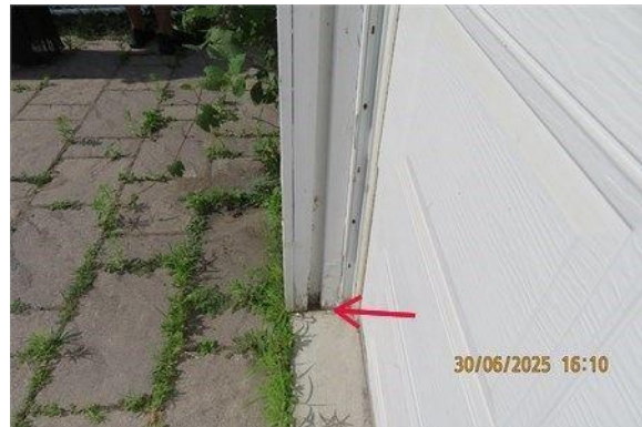
Joint d'étanchéité entre le montant de porte et le seuil
