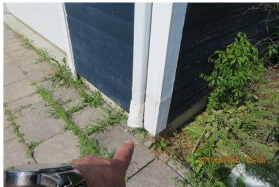
Descentes - Déversant trop près de la fondation
