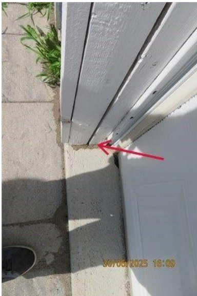
Joint d'étanchéité entre le montant de porte et le seuil
