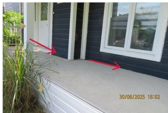
Dégagement - Insuffisant - À quelques endroits- entre le revêtement et une surface horizontale
