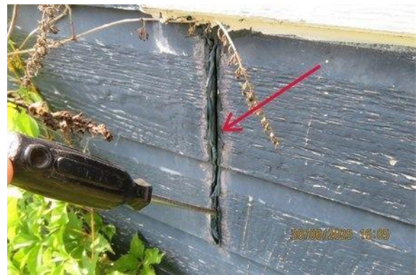
Joint de scellement à refaire
