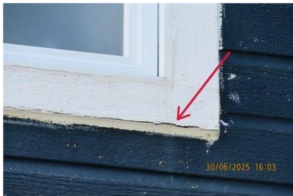
Joint de scellement à refaire
