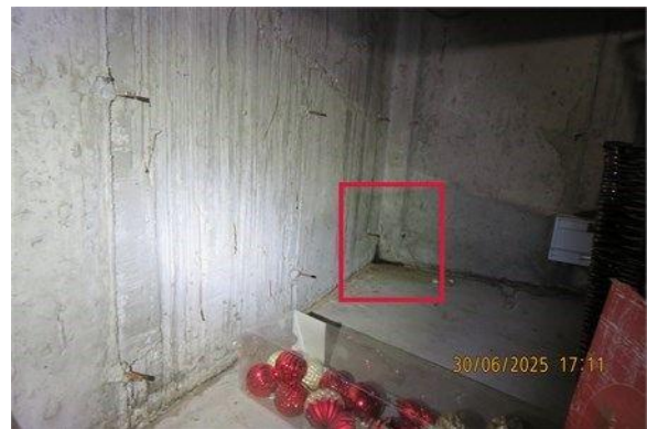
Signes d'infiltration/condensation - Infiltration d'eau observée
