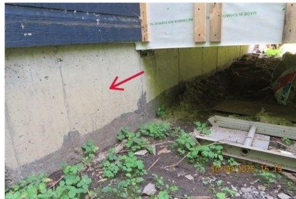
Crépi - Absent sur la fondation
