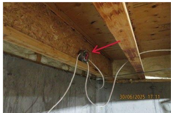
Connexion électrique ouverte ou inadéquate
