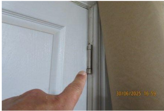
Porte menant au garage - Ferme-porte - Inefficace
