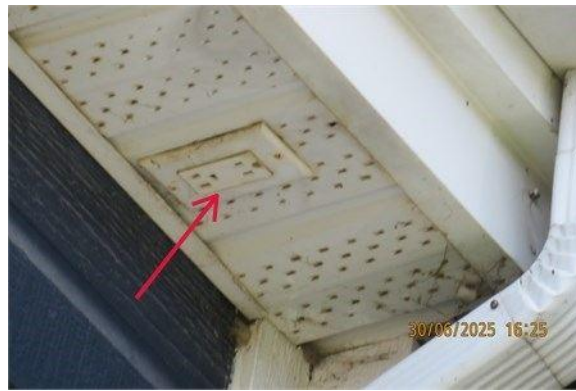
Prise extérieure - Non protégée par circuit DDFT
