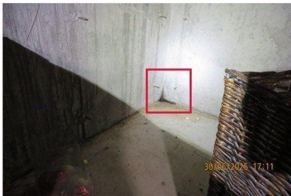
Signes d'infiltration/condensation - Infiltration d'eau observée
