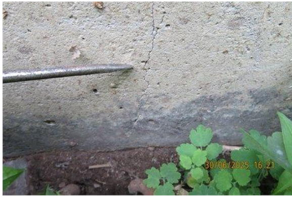
Béton - Fissures mineures à réparer - Côté droit
