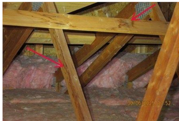
Signes d'infiltration - traces dans l'entretoit (sec lors de la visite)
