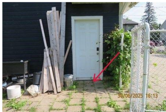
Porte à risque - Absence de drain extérieur devant
