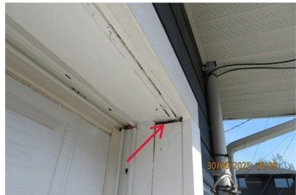
Joints de scellement - Ouvertures non scellées
