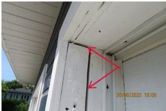
Joints de scellement - Ouvertures non scellées
