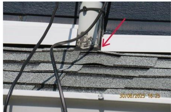
Joints de scellement - Ouvertures non scellées
