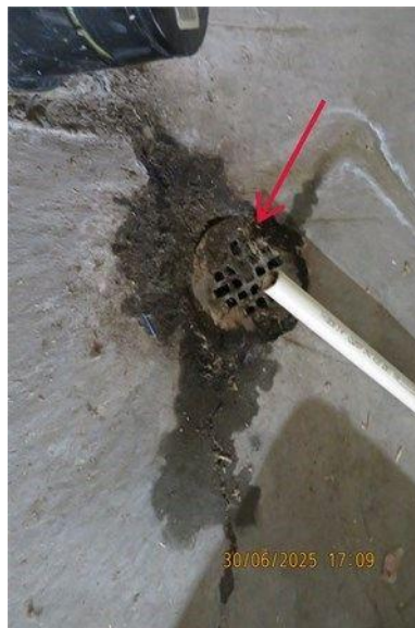
Drain de plancher
