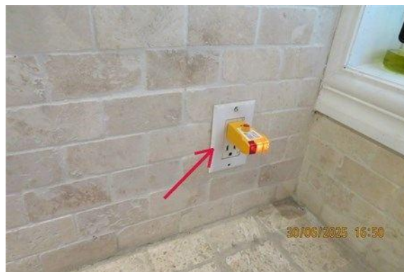
Prise de courant - Localisée à moins de 1.5 mètre d'un appareil de plomberie
