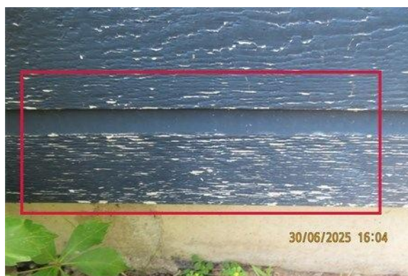
Déclin de bois - Détérioration de la protection hydrofuge
