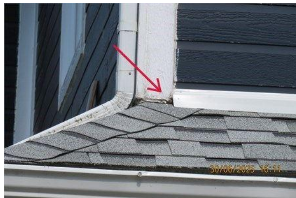
Solins - Déficience à la jonction du mur vertical et de la toiture
