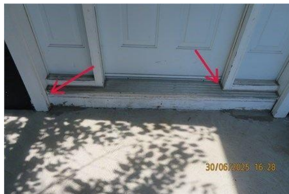
Détérioration du joint d'étanchéité entre le montant et le seuil d'une porte
